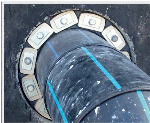
Водопроводные трубы диаметром 315 мм
