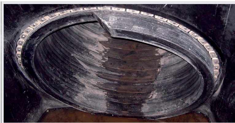
Канализационные трубы диаметром до 1400 мм
